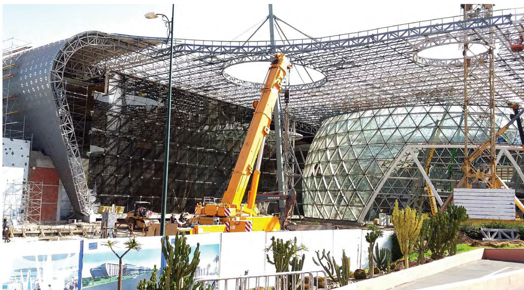
3 e terminal de l'Aéroport de Marrakech au MAROC (livraison prévue pour la COP22)
